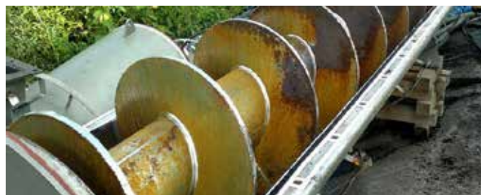
Transportador helicoidal danificado
