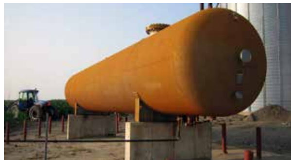
Vaso atacado por corrosão externa
